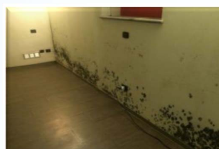
Risultato del cartongesso su una parete con umidità.
