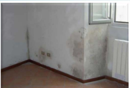
Presenza di muffa da condensa su parete umida/fredda e con differenza di temperatura trattata con cappotto esterno.
